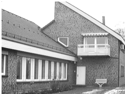
Abbildung 12: Gebäude mit Wärmebrücken (IEMB)
